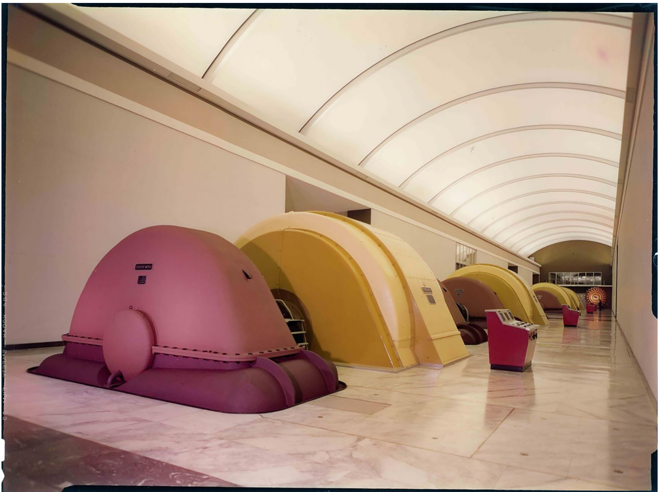
Vincenzo Vicari, Sala delle macchine nella centrale di Biasca / Salle des machines de l'usine de Biasca, 1965 © Vincenzo Vicari / Archivio storico della Città di Lugano
